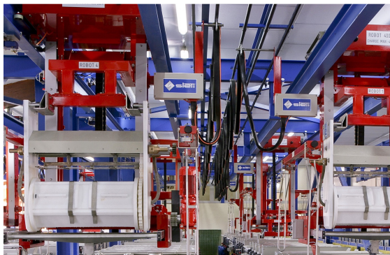
Chaine de traitement par voie électrolytique (tonneau)
