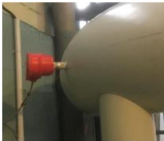
Image 19 : Exemple d'une gaine de ventilation équipée d'une sonde de température
