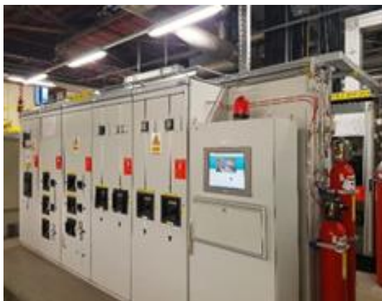
Image 27 : Armoires électriques équipées d'un système d'extinction par gaz neutre
